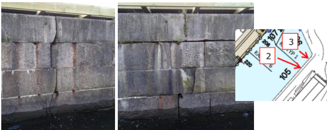
Foto: Sprickor i murkonstruktion kajplats 105
