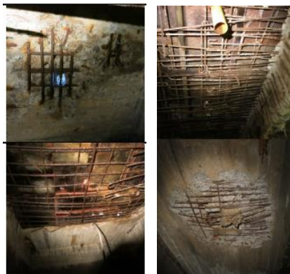
Foto: Exempel på skador undersida kaj
